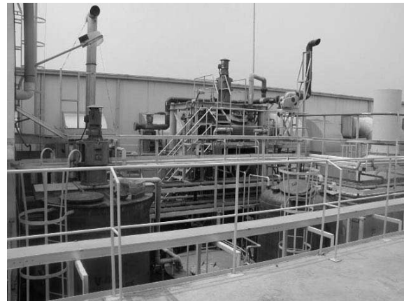
図-3 FCVの酸化銅処理設備の全景 Fig.3-Equipment of copper oxide treatment of FCV.
