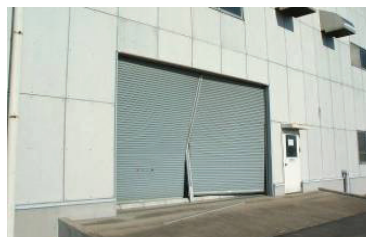
原動棟シャッター破損 (震災でのけが人なし)
