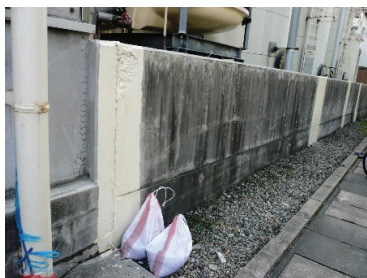
純水製造棟コンクリート亀裂発生 (薬品タンクの倒壊・漏洩・破損なし)
