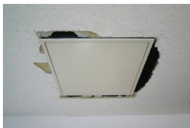
天井非常排気周りボード破損 (震災でのけが人なし)
