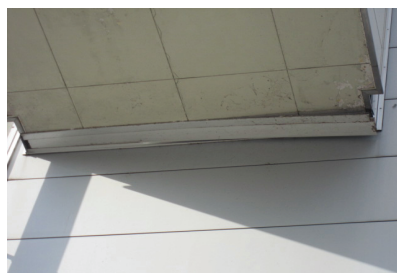
渡り廊下ジョイント部の破損(外部)
