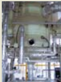
アルカリ濃縮装置
