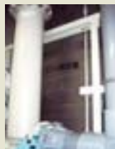
フッ素2次処理装置
