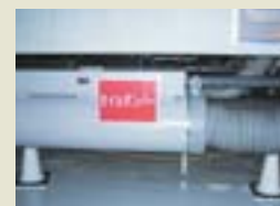
免震装置(オイルダンパー)
