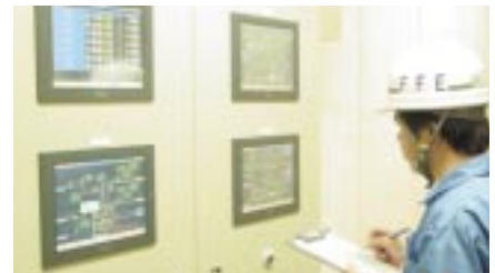
あきる野テクノロジセンター管理室
