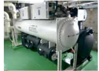
高効率ターボ冷凍機更新
